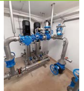
Die Technik der neuen Druckerhöhungsanlage
