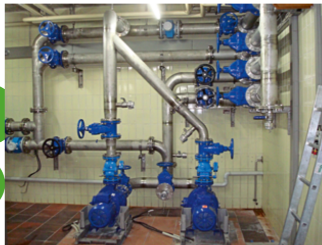
Neue Schlammleitungen aus Edelstahl
